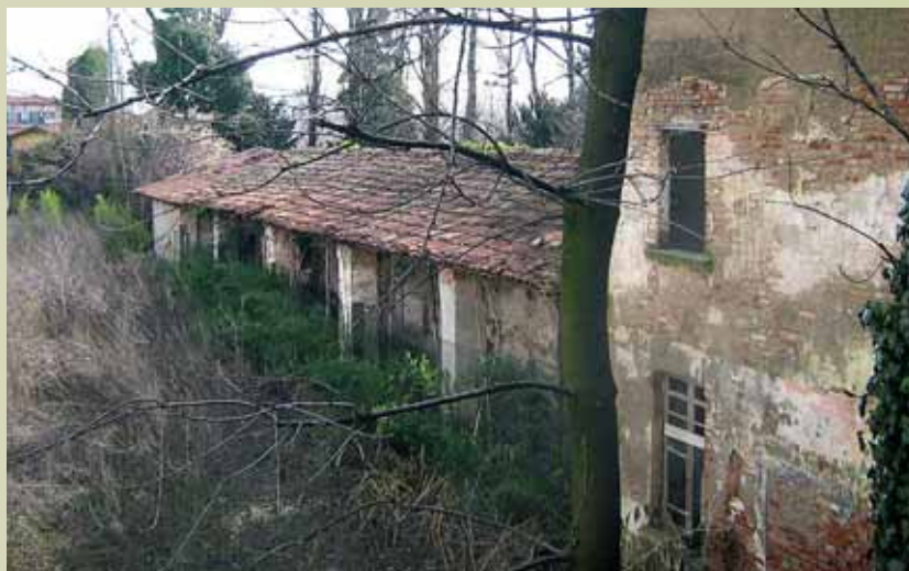
Una parte della sede della Fondazione che necessita di recupero
